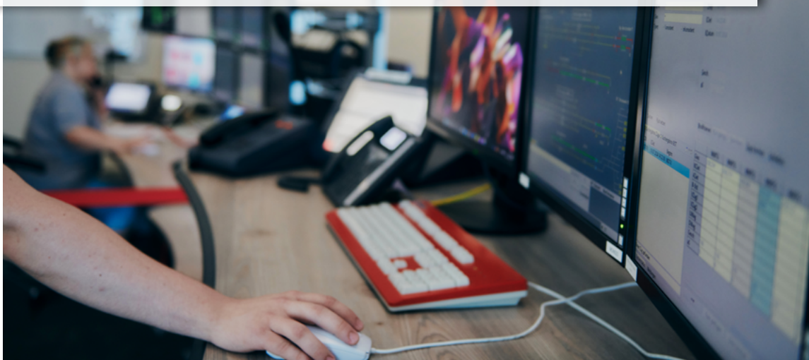
Interfaces utilisateur centrales dans le poste d'aiguillage numérique de Donauwörth
