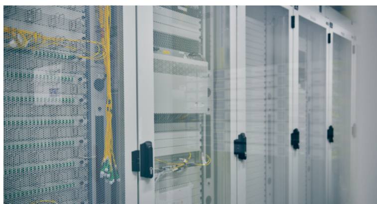
Serverraum im Digitalen Stellwerk Donauwörth
